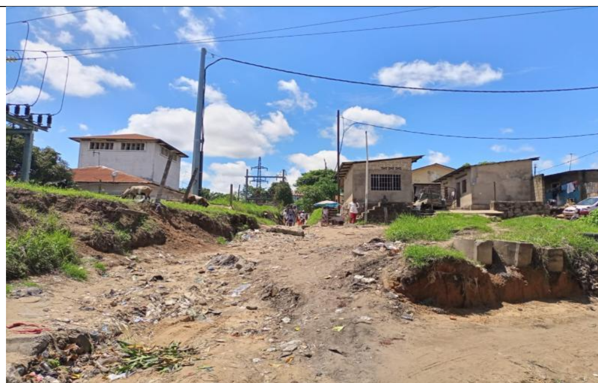
Photos 4 : Etat du site et évolution de l'érosion dans le poste de Makala
